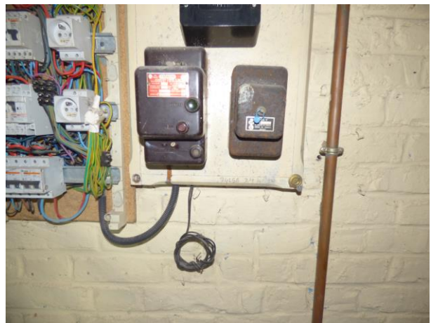
Absence de protection des conducteurs
