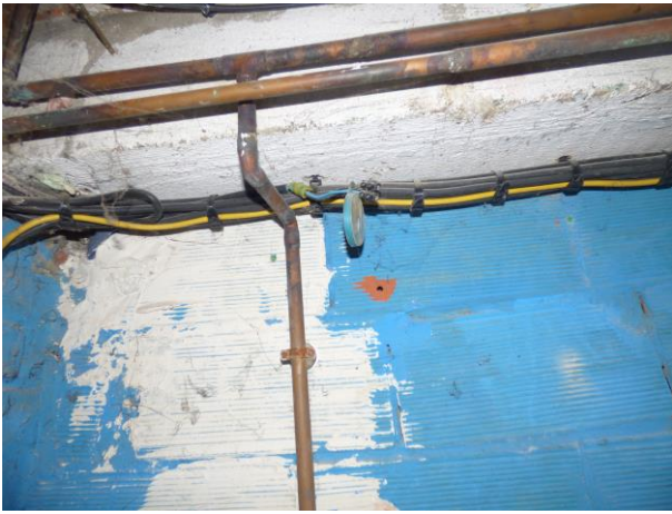
Absence de protection des conducteurs et risque de contact direct
