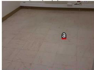
Pvlt 742-JE-1 : Dalles de sol (beiges) amiantées
