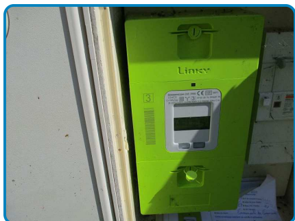
COMPTEUR sur Install. n°1 (dans Extérieur bâti)
