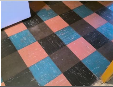
Photo n° PhA002 Localisation : Volume 2 Ouvrage : Planchers Partie d'ouvrage : Dalles de sol Description : Dalles de sol Localisation sur croquis : M002
