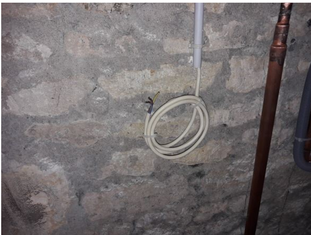
Connexions nues sous tension (Cellier, Grenier1, Grenier4, Grenier6, Cave sous Escalier, Bureau3, Bureau4, Chaufferie, Pièce1, Pièce4)
