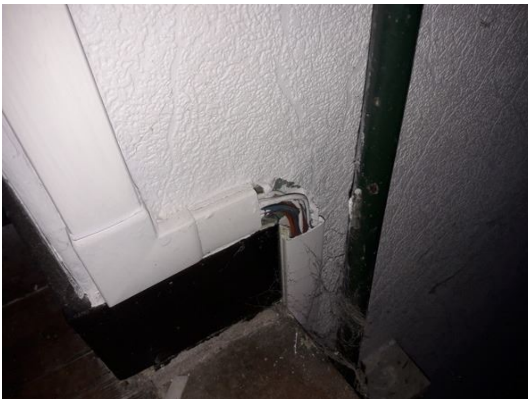
Absence de goulottes de protection (Palier)
