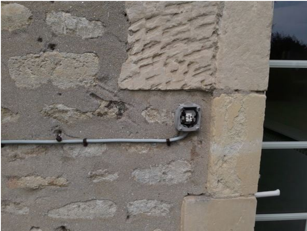
Interrupteur extérieur cassé (Façades)
