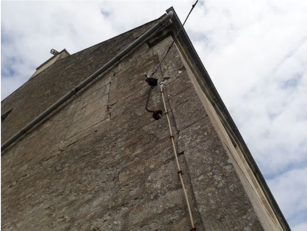
Présence de matériels vétustes (Garage,Façades,Grenier1)
