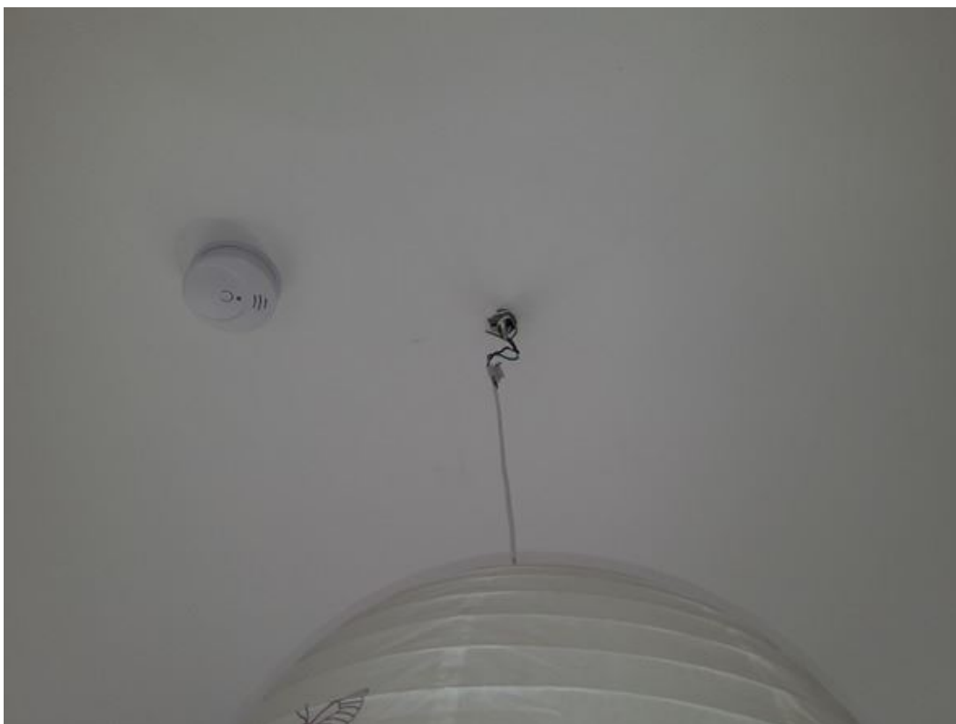
Connexions nues sous tension (Cellier, Grenier1, Grenier4, Grenier6, Cave sous Escalier, Bureau3, Bureau4, Chaufferie, Pièce1, Pièce4)
