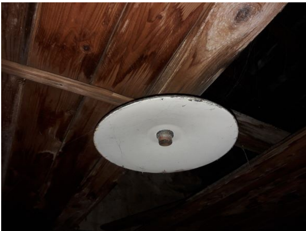
Présence de matériels vétustes (Garage,Façades,Grenier1)
