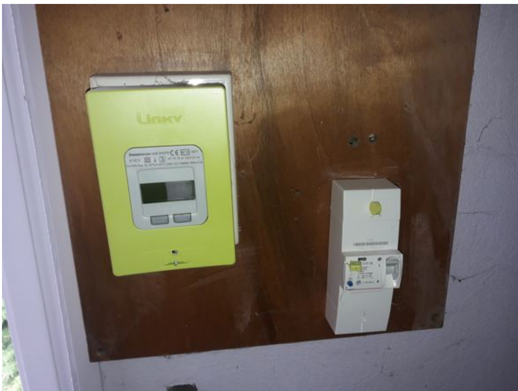
Disjoncteur de branchement
