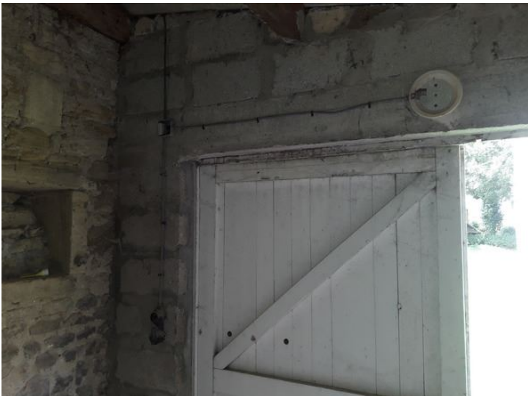
Présence de matériels vétustes (Garage, Façades, Grenier1)
