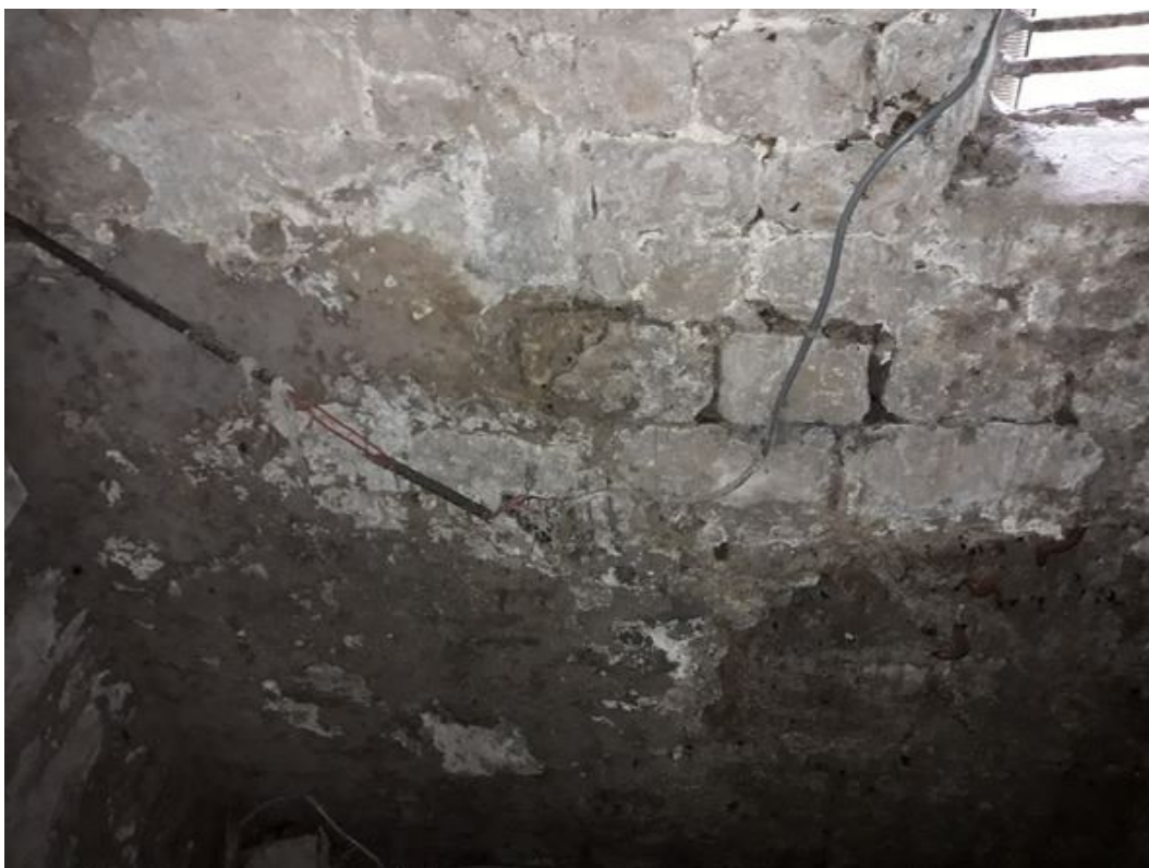
Connexions nues sous tension (Cellier, Grenier1, Grenier4, Grenier6, Cave sous Escalier, Bureau3, Bureau4, Chaufferie, Pièce1, Pièce4)
