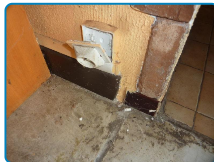
Anomalie B.7.3 a sur Install. n°1
