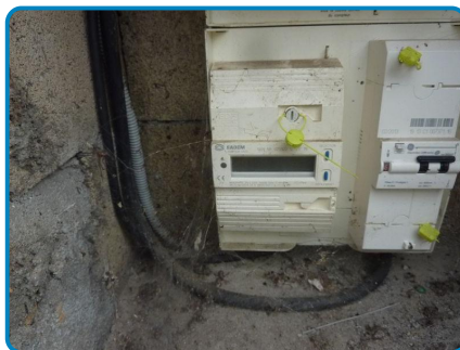
COMPTEUR sur Install. n°1 (dans RDC Extérieur)
