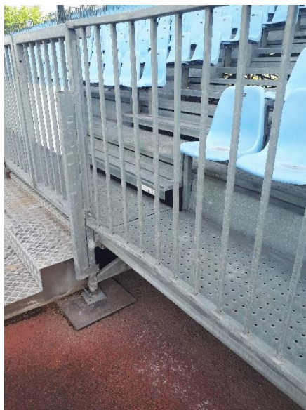
Figure 2 – Déformations gardes corps
