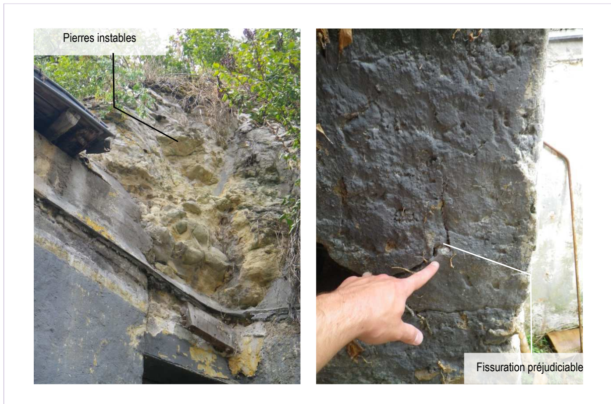
Figure 9 : points d'altération à proximité des caves n°3 et 4
