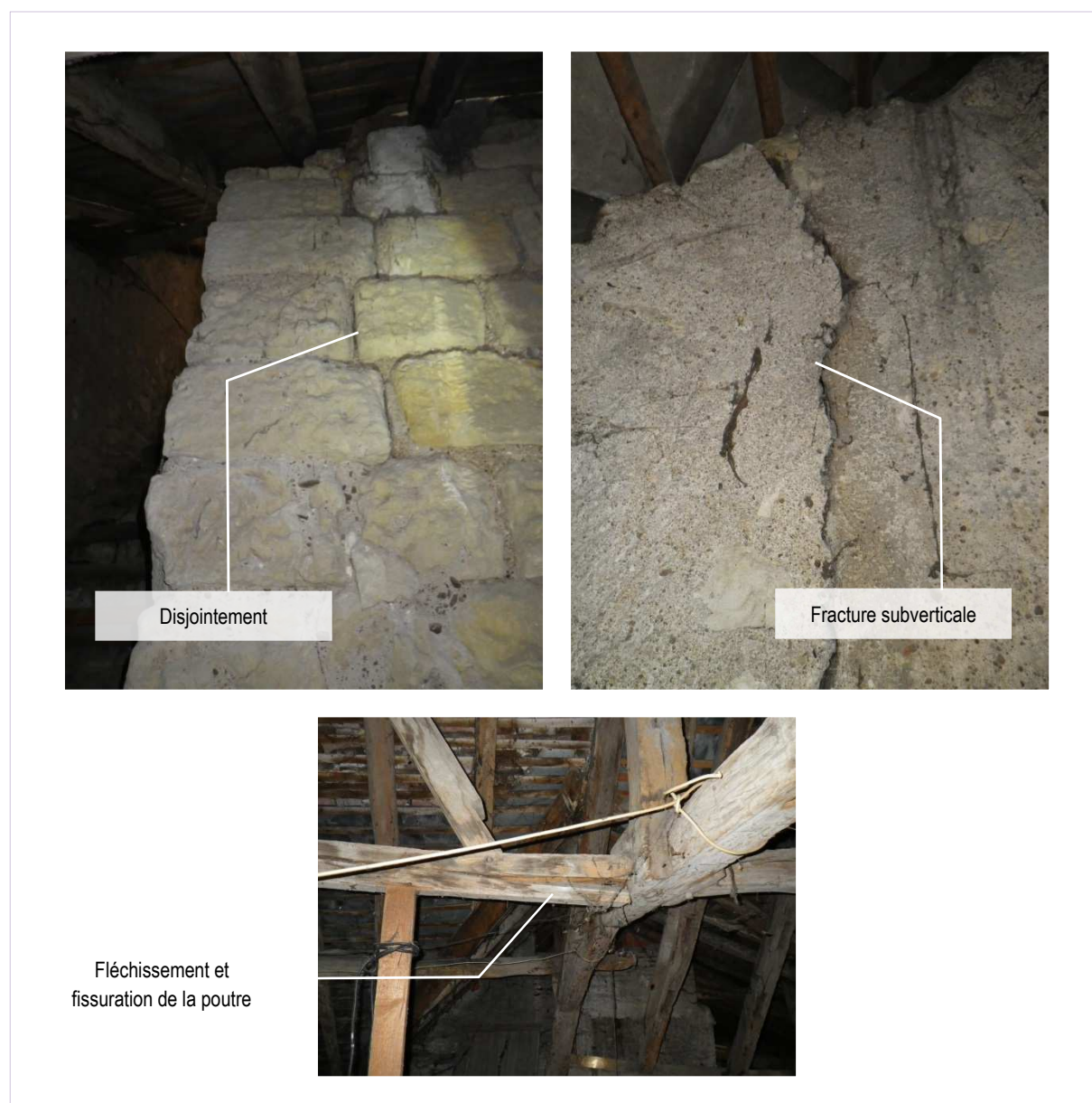
Figure 10 : altération d'éléments structurels du bâtiment
